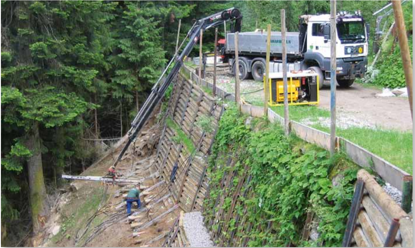
Risanamento di un'opera di sostegno realizzato dalla ditta HTB di Innsbruck impiegando il sistema DRILL DRAIN® e TITAN 40/27.
